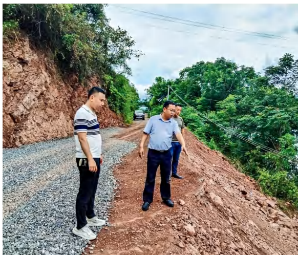
7月，强降雨后，湘西自治州人大代表、泸溪县武溪镇党委书记谭永攀（中）现场察看刘家滩村坍塌路段。
